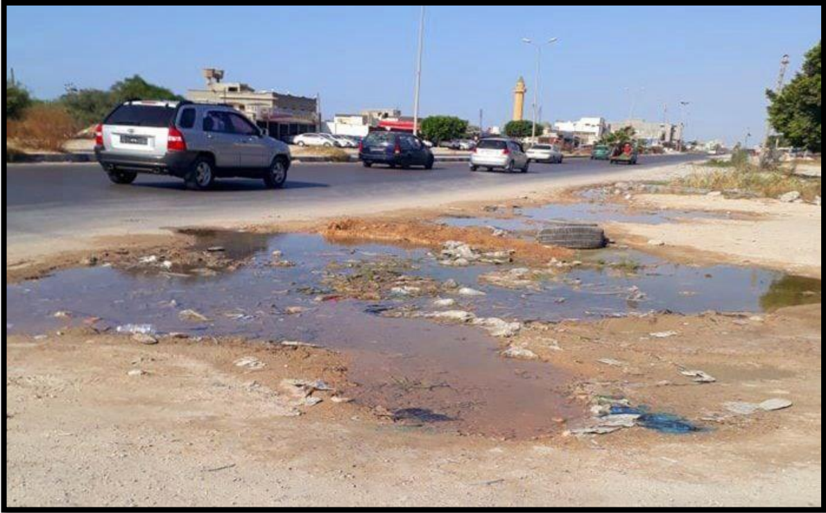
الصورة (18) تسريب شبكات الصرف الصحي داخل المدينة
