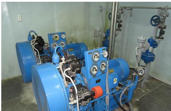
شكل رقم (8) يوضح منظومة ضغط الهواء
